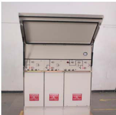
Siemens RMU type 8DJH ST
